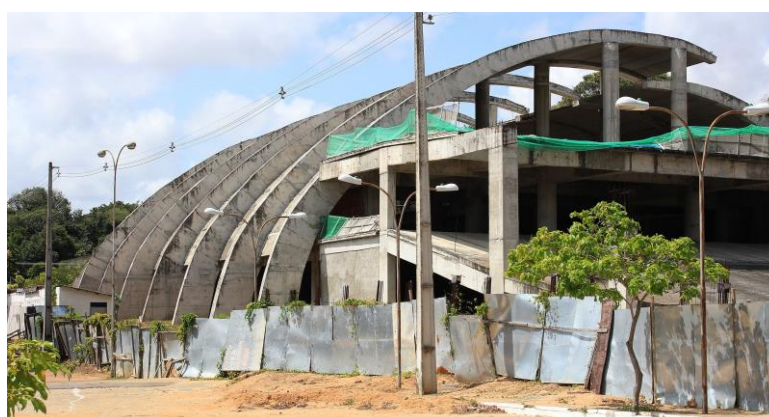
Figura 5: Atual situação do prédio que têm 97% da obra executada, entretanto os trabalhos encontram-se paralisados Fonte: Click Pb. 2016.
